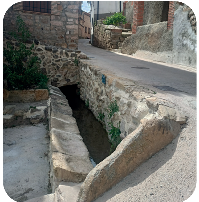
Figura 5: Infraestructura (acequia) para la distribución del agua tradicional en el pueblo de Olba, alto Mijares.
